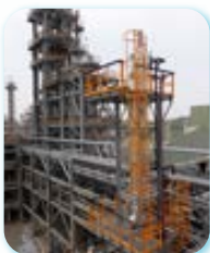
高效率熱交換及 分散性設備
