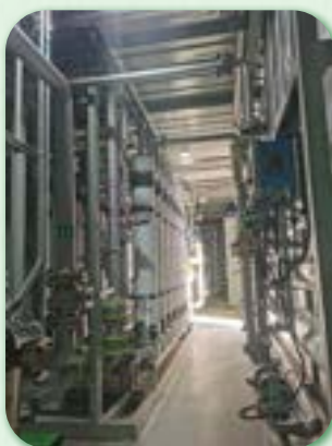
南通實業廢水回收設備
