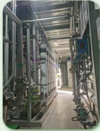
南通实业废水回收设备
